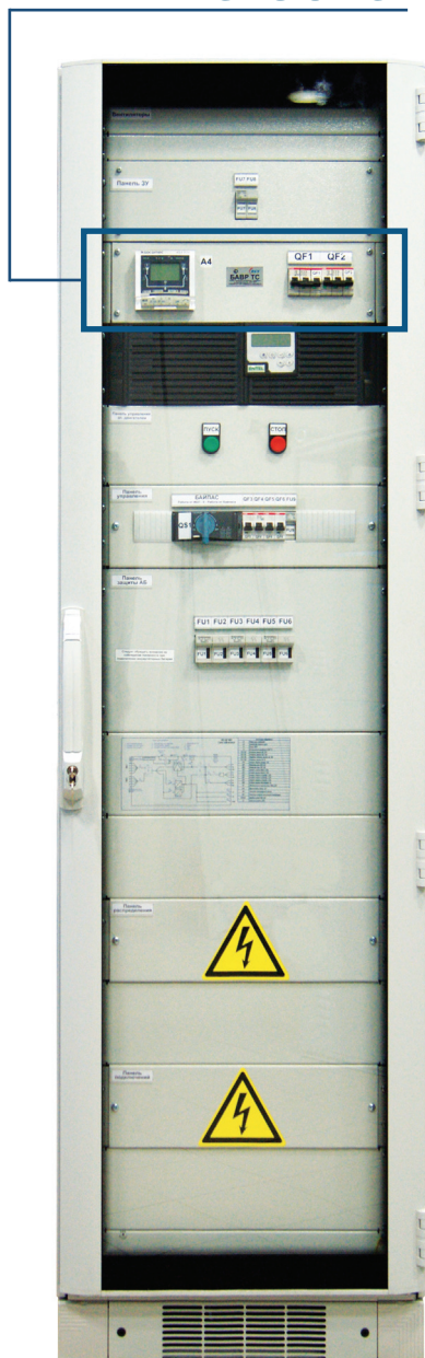
БАВР ТС в стойке
